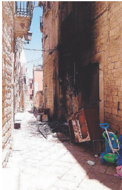
DANNI L'effetto dell'incendio
